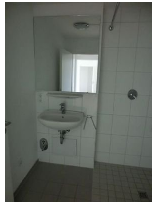
Bad mit Dusche und WC
